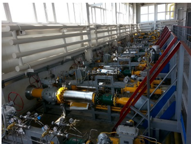
Рис.3. Узлы редуцирования и узлы очистки АГРС «Исток-600» в капитальном здании
